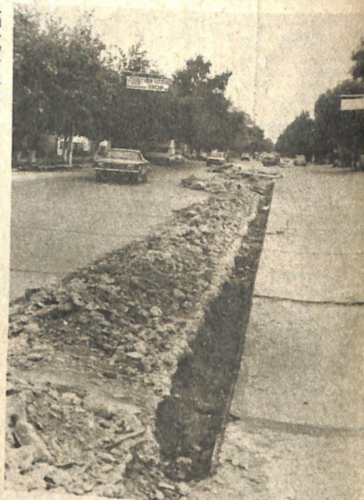
La zanja abierta, iniciando el primer tramo de iluminación de la avenida Libertador y Dr. Federico Cantoni al oeste.
