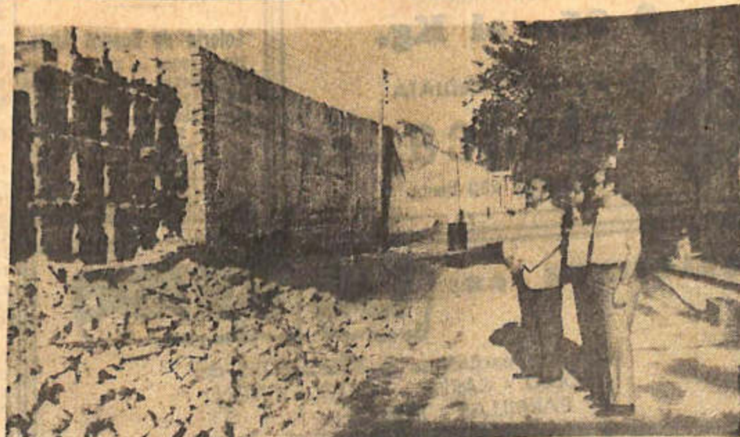
El derrumbe de la galería Sur del cementerio ha dejado a la vista los nichos con sus féretros. El traslado y reducción de los restos y la demolición, obligan a urgentes medidas de emergencia.
