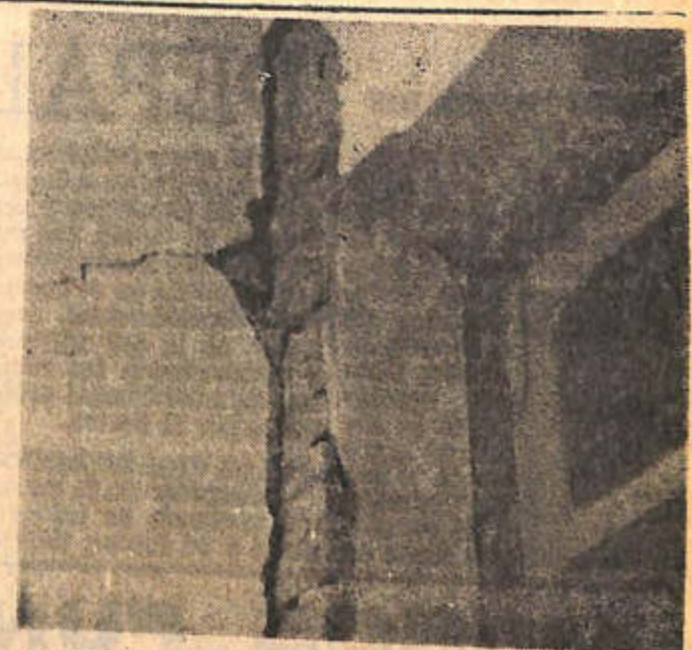
Rotura y separación de muros en el local alquilado donde funcionaba el departamento de Artes Plásticas, que deberá ser demolido
