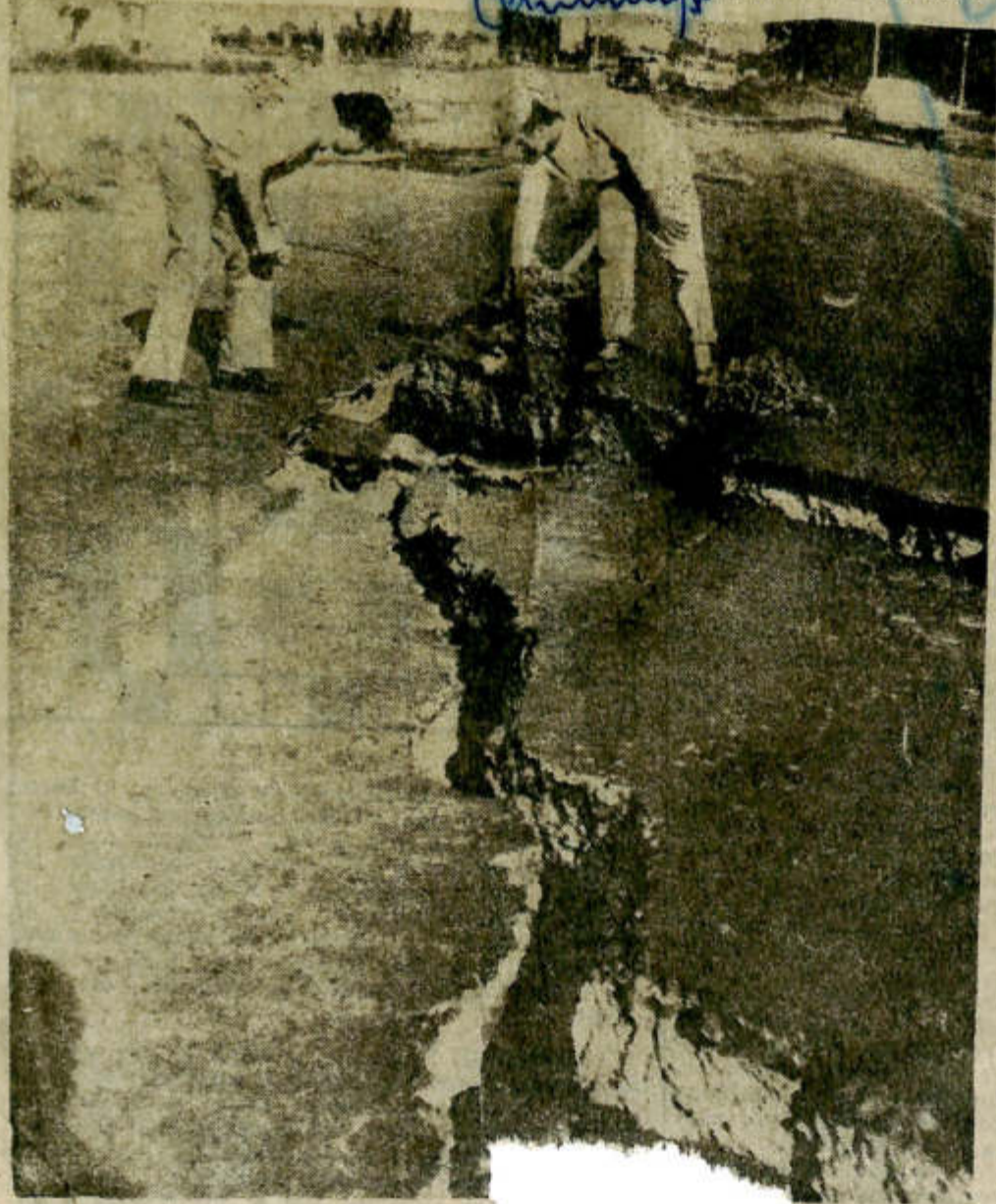
Una muestra del tremendo efecto de comada en el kilómetro 16 de la ru- ta. Su profundidad fue
