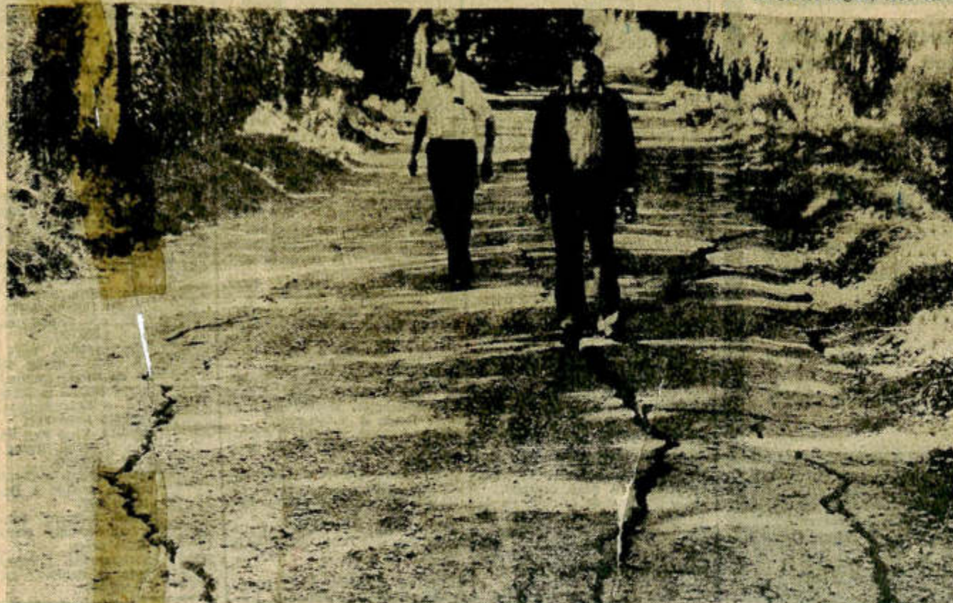
Las calles de Medano de Oro ofrecían este aspecto en la mañana de ayer. Profundas y extensas grietas a lo largo y ancho de las arterias. De muchas de ellas afloraba agua que, en algunos casos inundó parraicos.
