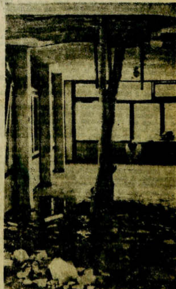
EL DEPOSITO aéreo de agua potable de la escuela Juan Juárez, de Angaco, se desplomó sobre el techo con su pesada carga de casi 10 mil litros. El derrumbe ocasionó serios daños en un sector del salón de actos y en dos aulas. El techo debió ser apuntalado y habrá que demoler una parte del edificio.
