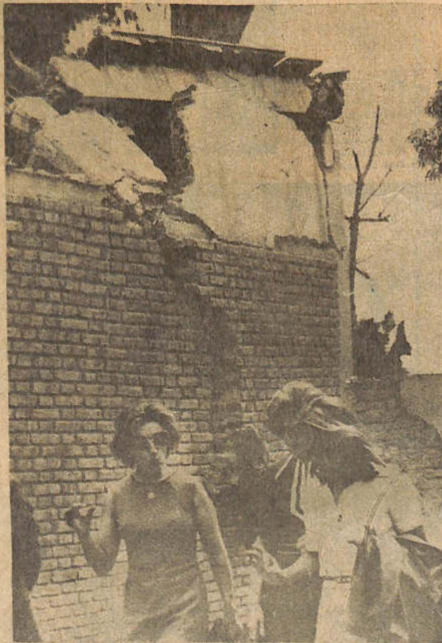
La esposa del presidente y otras damas que le acompañan, observan los tremendos daños verificados en la estructura de la escuela Hipólito Vieytes.
