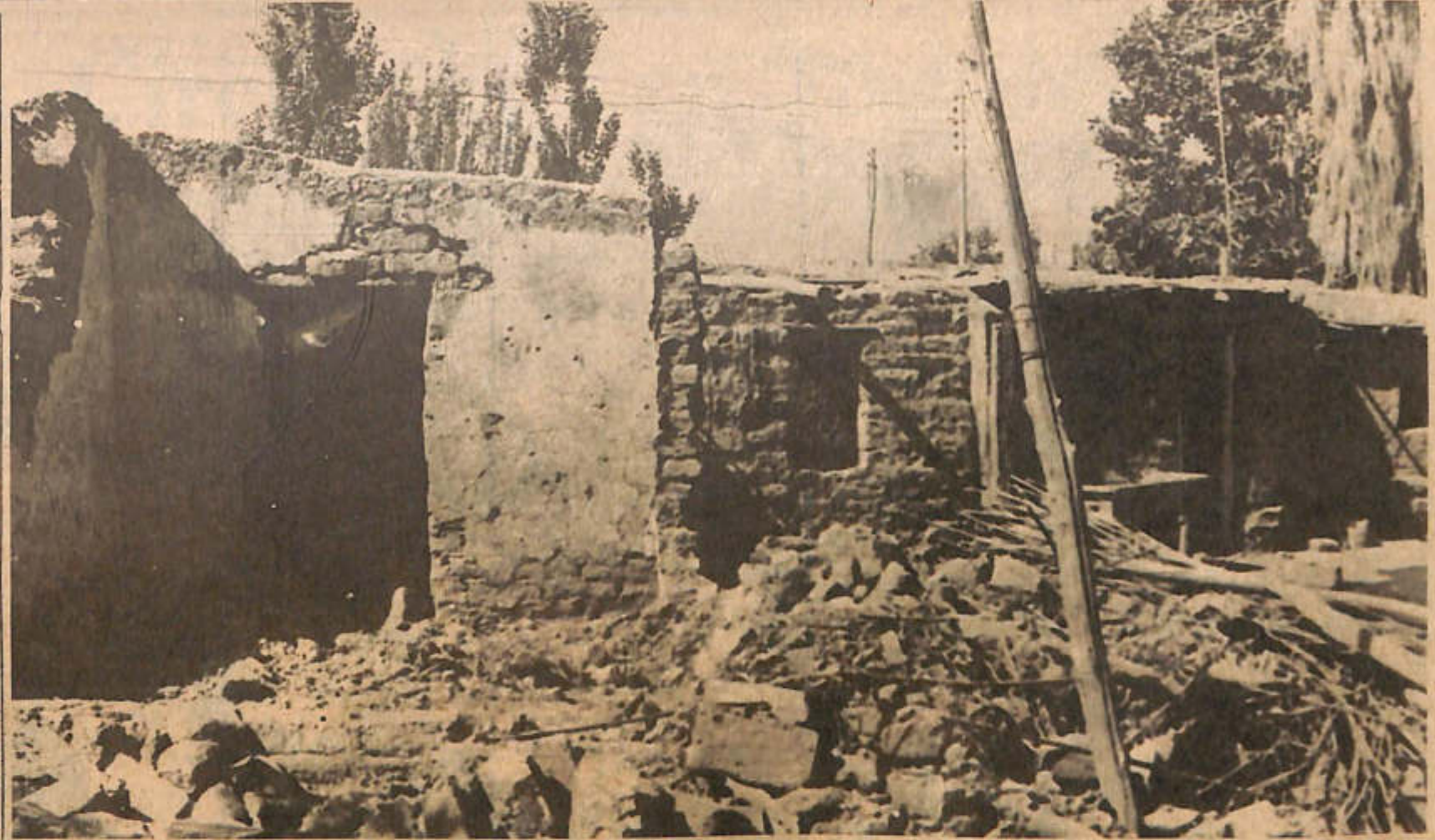
Viviendas de adobe que no soportaron la intensidad del movimiento sísmico del 23 de noviembre y quedaron derrumbadas.
