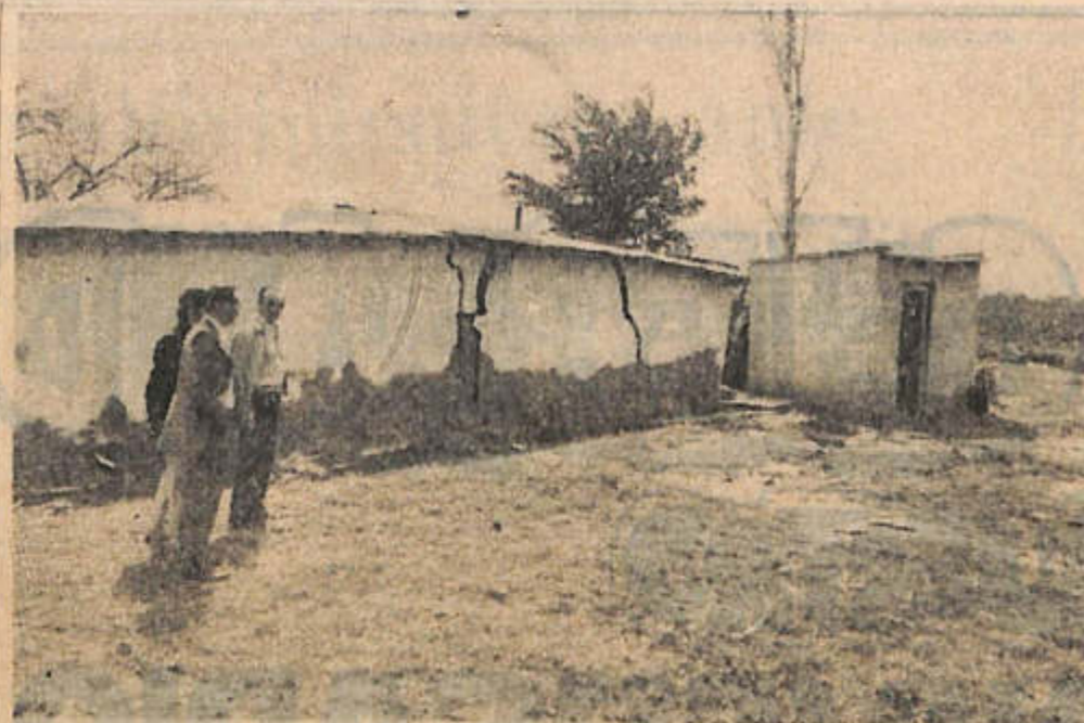
El comodoro Ramírez Dolan observa los daños sufridos por una vivienda.
