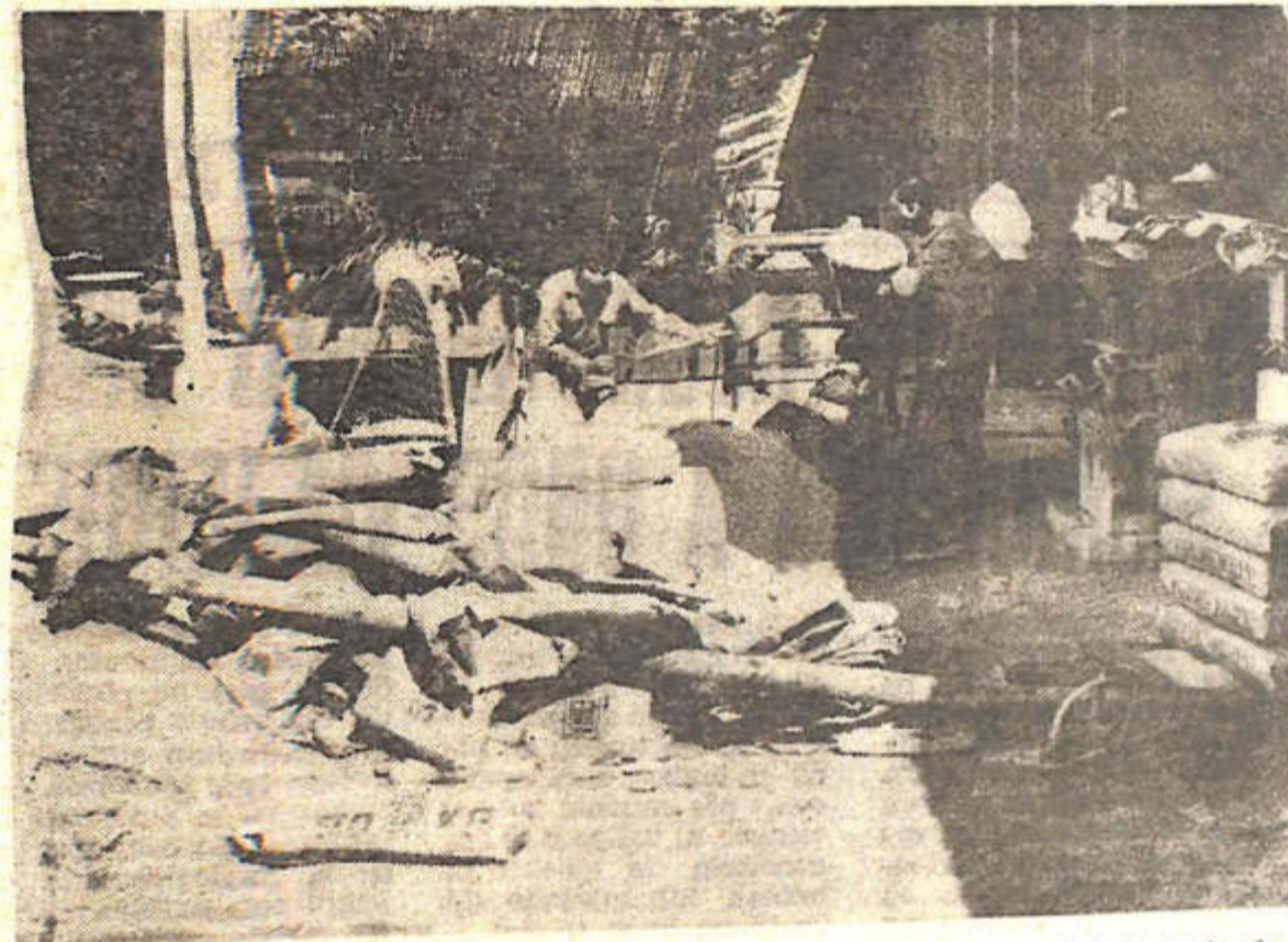
Orientada a paliar la difícil situación de los damnificados por el terremoto de noviembre último, se puso en marcha en el departamento Sarmiento, promovido por la municipalidad, la fabricación de bloques para levantar viviendas por el sistema de ayuda mutua.
