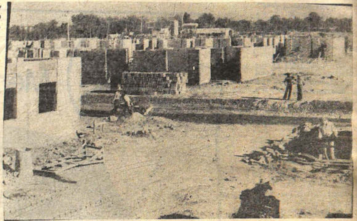
En 180 días a contar del 13 de enero, debe estar terminado el barrio Las Heras, en Desamparados, que constará de 162 viviendas, con todas las instalaciones, pavimento de calles, arbolado y alumbrado. Se trabaja a ritmo acelerado en la obra.
