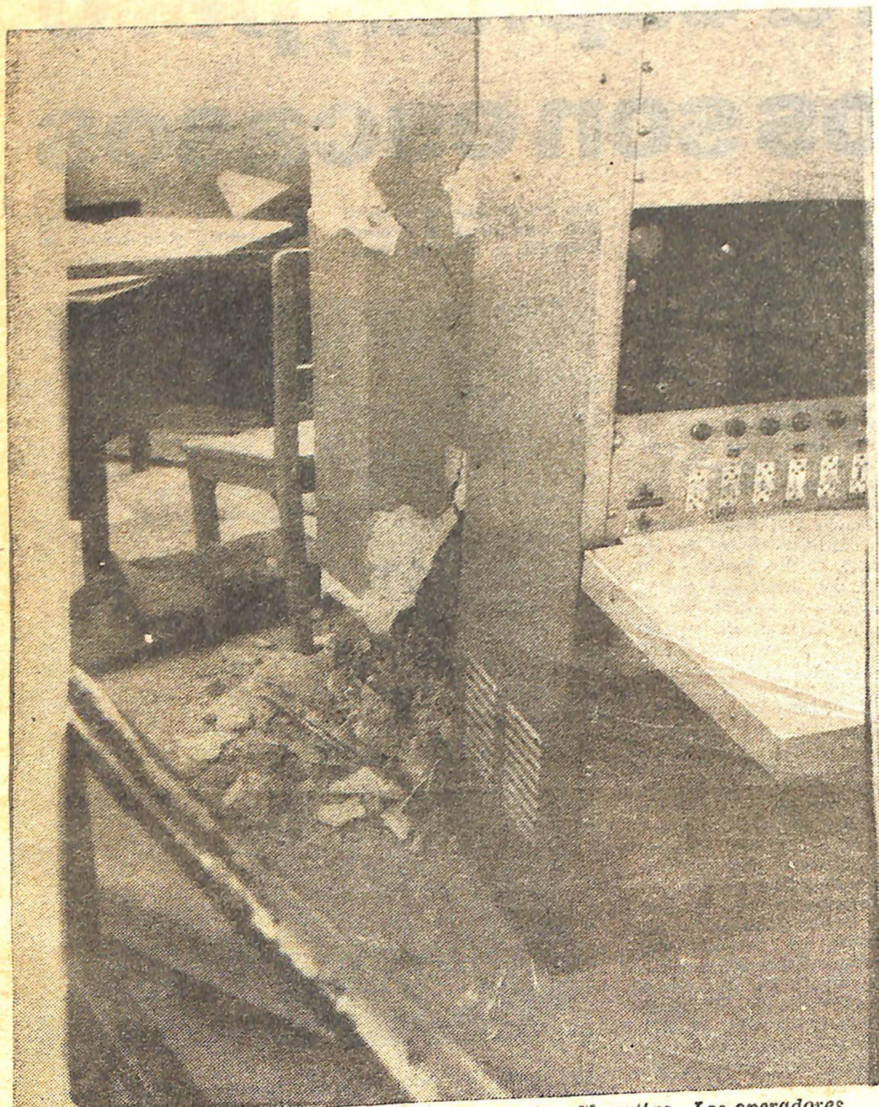
Destrozos en la torre de vuelo del aeropuerto de Las Chacritas. Los operadores debieron abandonar precipitadamente la misma desde una altura aproximada a los 20 metros. Sin embargo nadie resultó herido.
