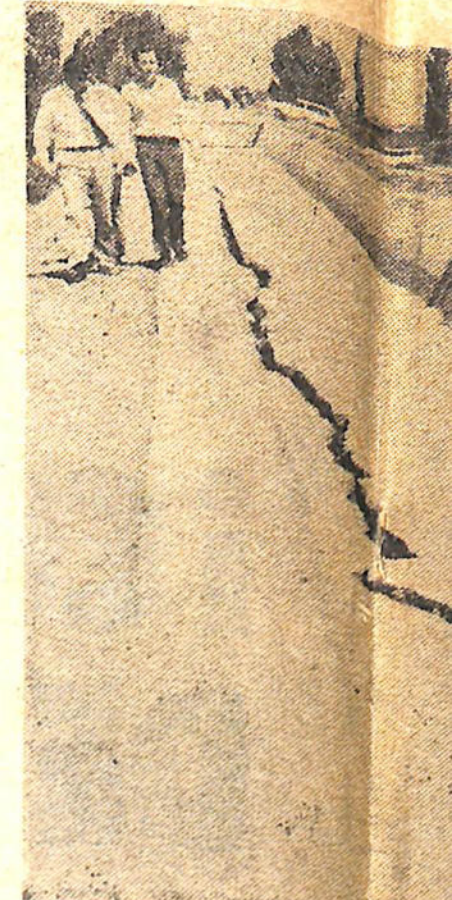
IMPORTANTES daños sufrieron riego, del denominado "Proyecto departamentos Caucete, 25 de Mayo
