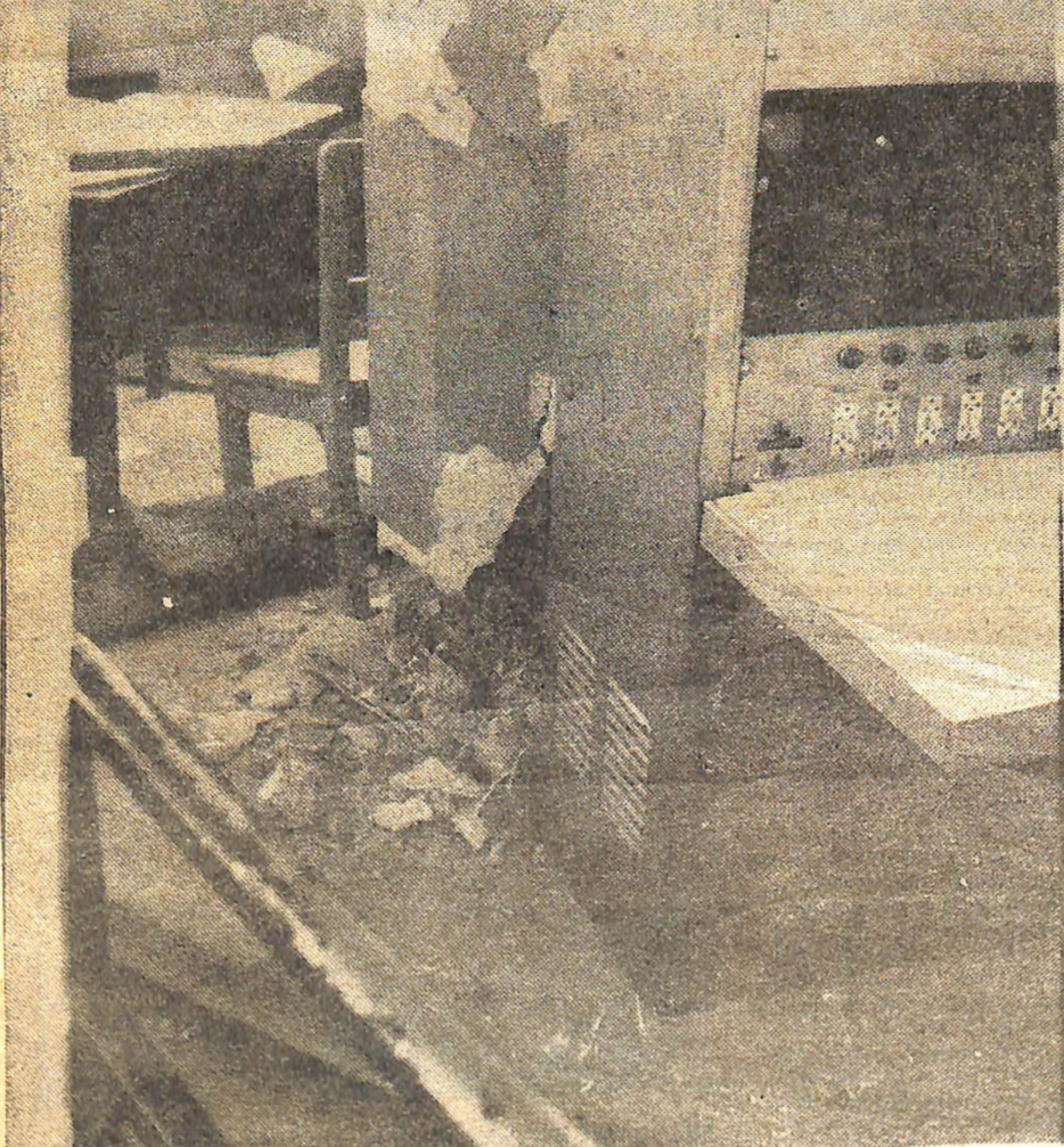
Destrozos en la torre de vuelo del aeropuerto de Las Chacritas. Los operadores debieron abandonar precipitadamente la misma desde una altura aproximada a los 20 metros. Sin embargo nadie resultó herido.
